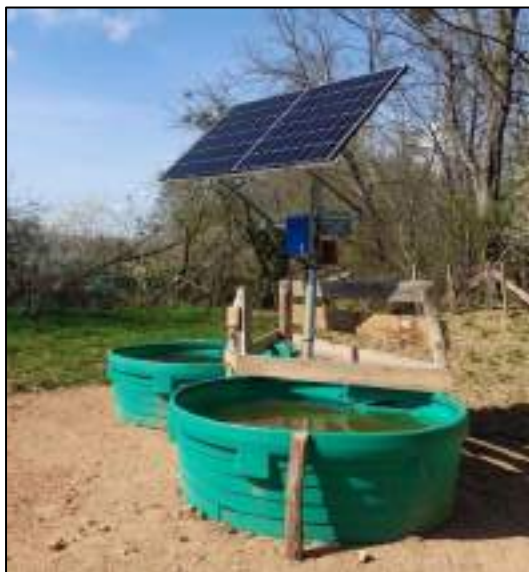
Figure 5 : Puisard solaire sur le Rhodon à Perreux
