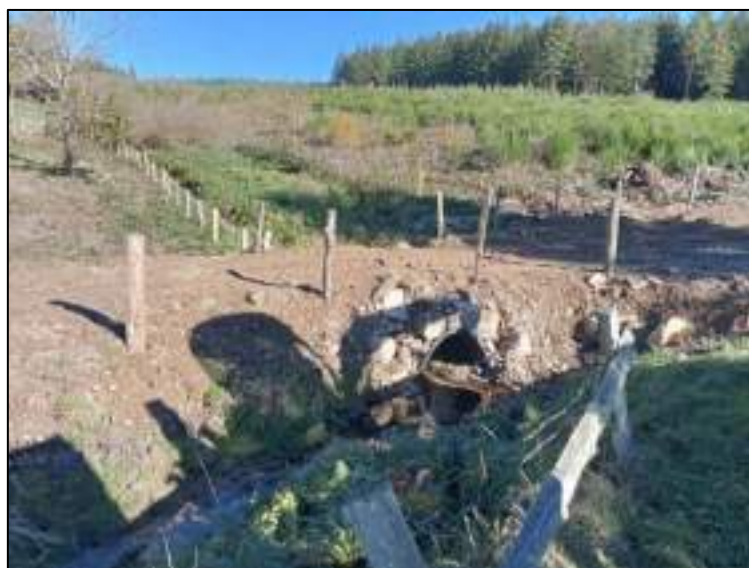
Figure 8 : Passage busé à Ranchal sur un petit affluent du Reins
